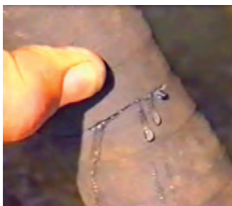
شکل ۶. نشتی از شیلنگ ها
