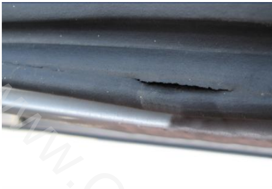
شكل 9- پارگي در اثر فرسودگي نوار دور درب
