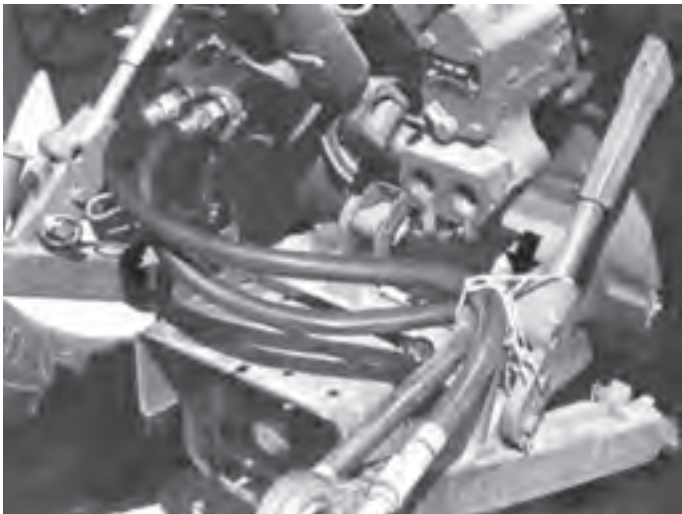
شکل ۱۳-۶- مهار نامناسب شیلنگ‌های هیدرولیک
