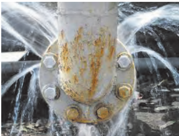
شکل ۲۴-۵. نشست آب بر اثر ضربه قوچ
