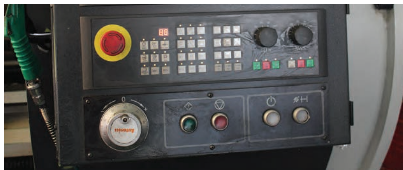
شکل ۱۶- قسمت اپراتوری سیستم کنترل
